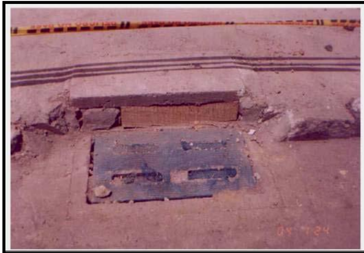
Figura 8.21 Protección de sumideros
