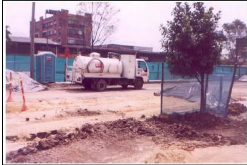
Figura 8.16 Foto de cabina sanitaria portátil y vehículo de mantenimiento
